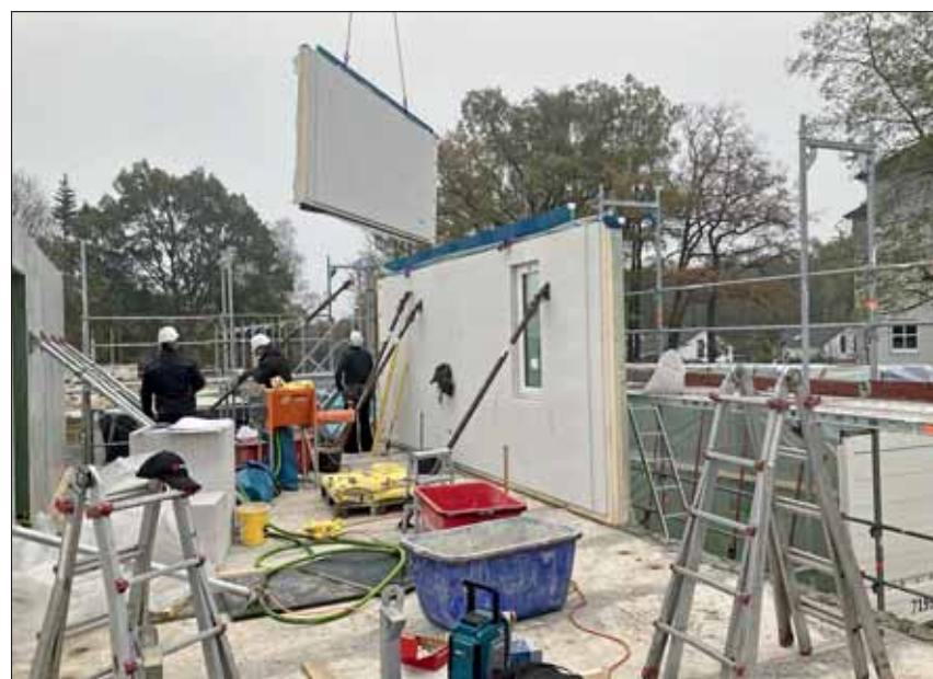
Das Projekt Wittinger Straße in der Bauphase. Vorfertigung, kurze Bauzeiten und Risikominimierung während der Baustellenarbeiten gehörten zu den Gründen, warum B&O überhaupt wieder in den Wohnungsneubau eingestiegen ist.
